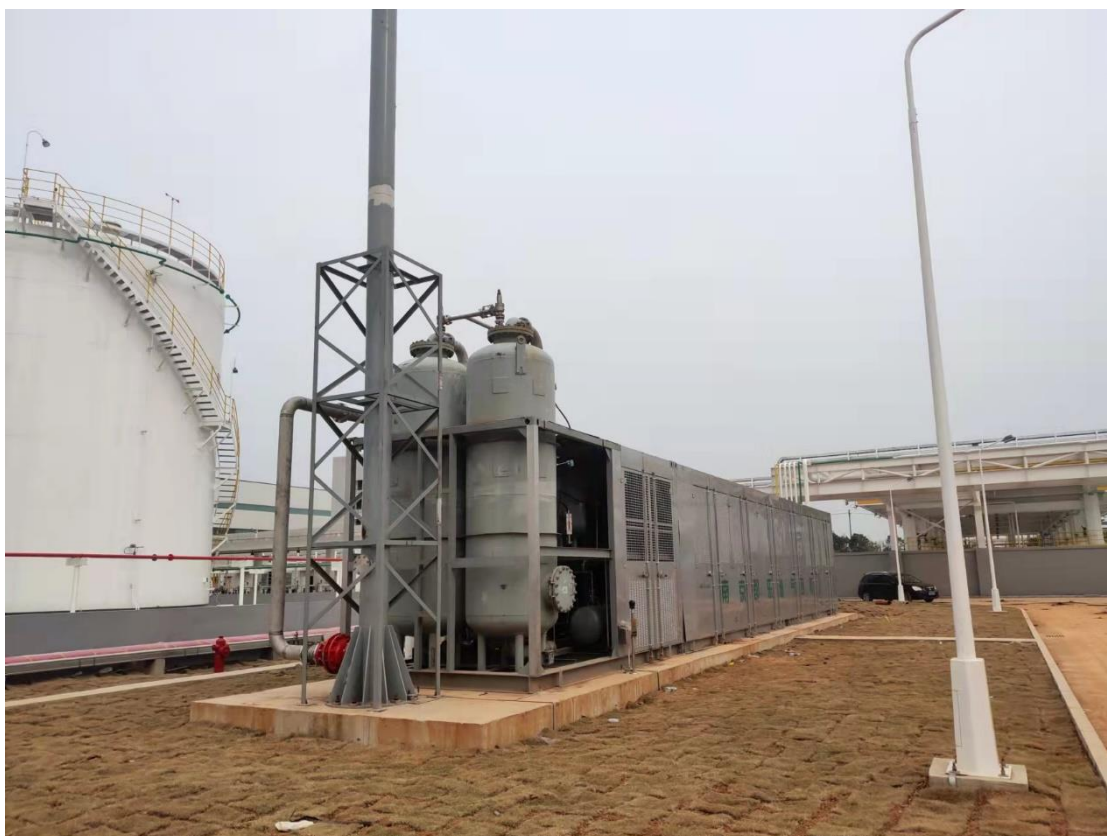
图 4.1.2-1 库区油气回收装置
