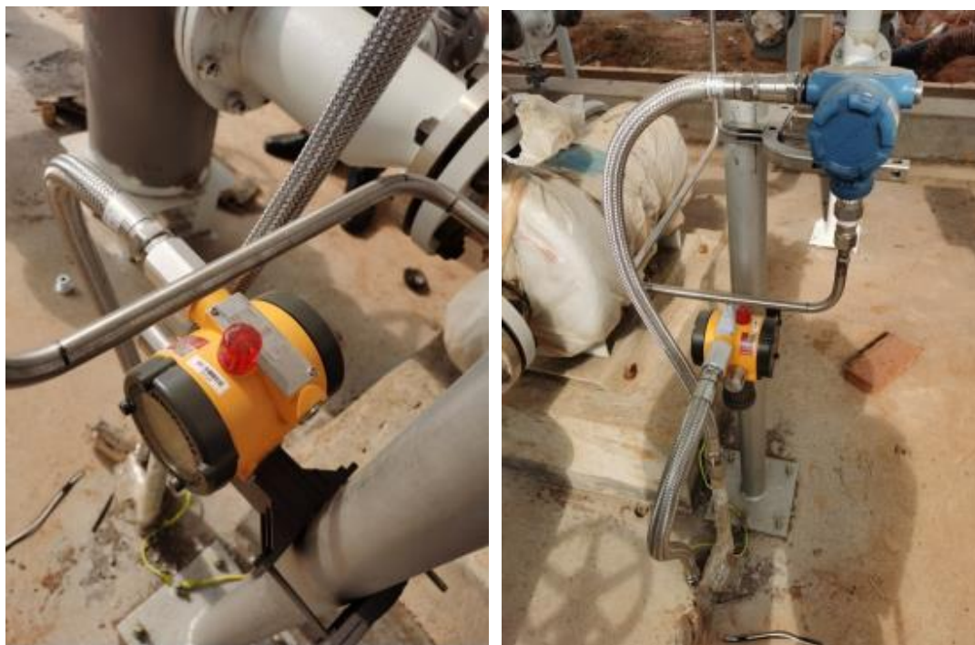
图 4.1.2-2 库区可燃气体探测器（探测范围 10m 内）+压力计
